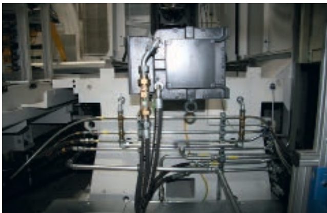
Gut zu sehen ist hier ein Teil der Wasserversorgung für die eingegossenen Wasserkreisläufe, die die Temperaturstabilisierung der Hauptachsen sicherstellen.
